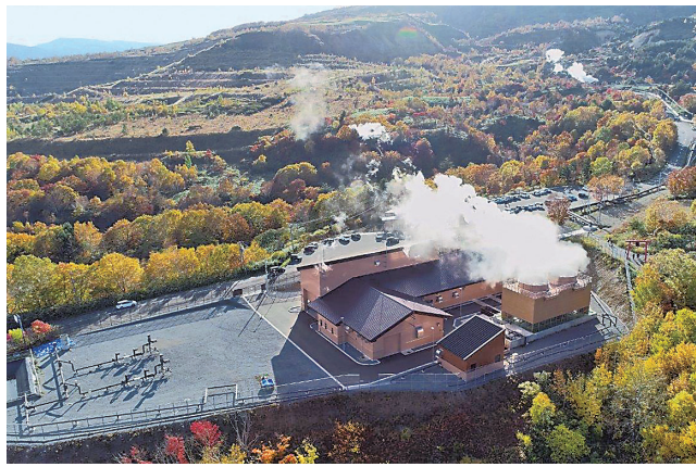
日重化などが運営する 松尾八幡平地熱
